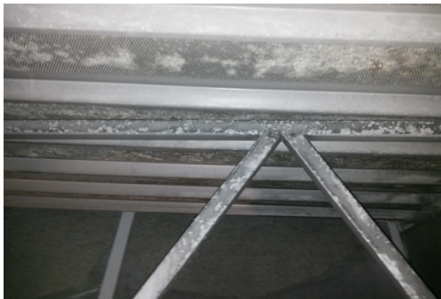
Figura 8 – Esempio di perdita dell'integrità dello strato di zinco a protezione della struttura metallica
