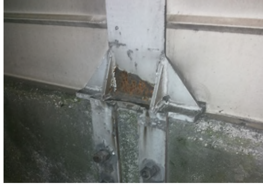
Figura 7 – Esempio di corrosione del montante.
