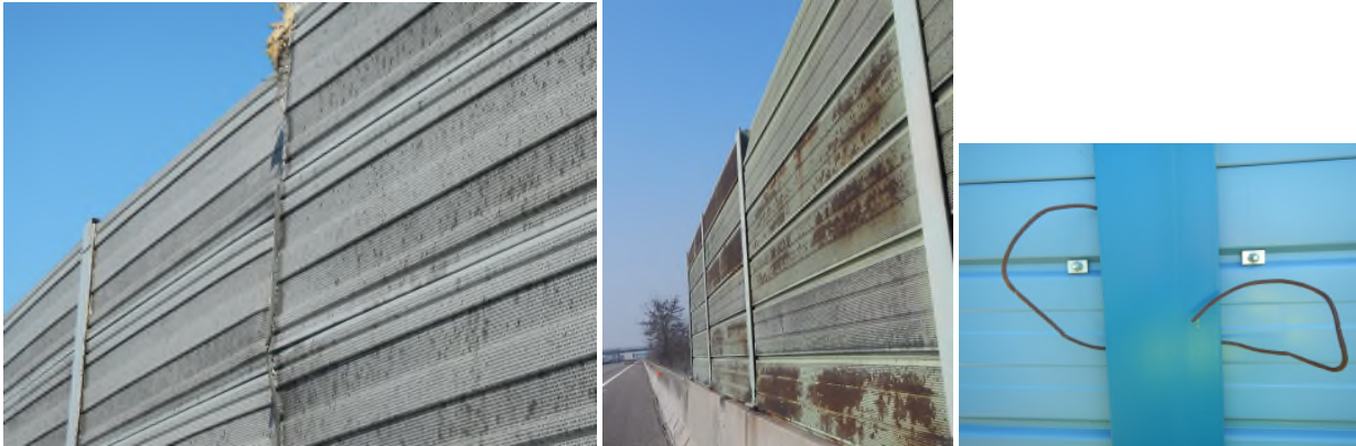
Figura 9 – Esempio di non integrità della pannellatura di barriere fonoassorbenti.
